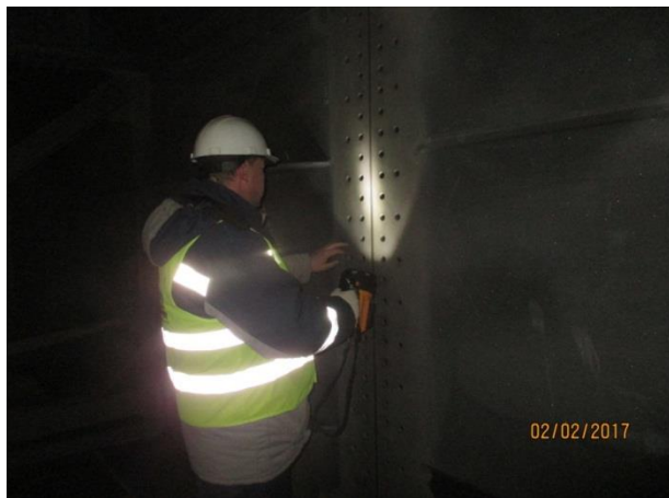
Пролет 68-69 (а/д мост). Контроль качества абразивоструйной очистки контактных поверхностей фрикционных соединений в стыках главных балок (стык №10, ось Г). 02.2017
