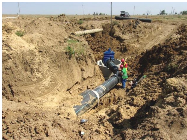
08.2015. Работы ведет ООО «Газсервис». Переустройство сетей водоснабжения на ПК36+45. Монтаж задвижки Ø600 мм. в колодце К2.
