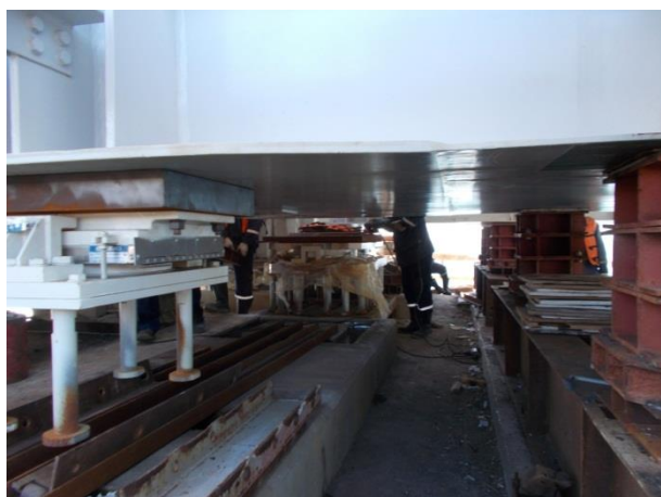
Пролётное строение в осях опор №№ 98-99 (ж/д мост). Крепление опорных частей к нижнему поясу пролётного строения до установки пролётного строения в проектное положение по осям главных коробчатых балок В-Г, по оси опирания на опоре 98.2 ж/д. 09.2018
