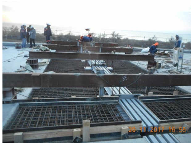
Пролётное строение в осях опор №151-159 (а/д мост). Приемочный контроль устройства деформационного шва над опорой №155а.д. в осях главных балок 1-2. 11.2017
