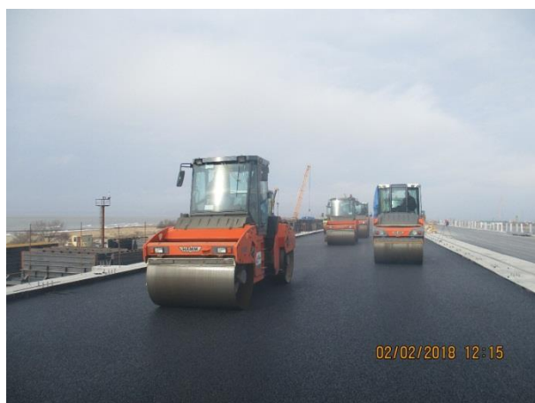
Устройство верхнего слоя покрытия из щебеночно-мастичного асфальтобетона ЩМА-20 h=5 см. Оп №155-№163 ось 1-2. 02.2018
