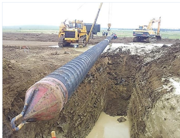
06.2015. Работы ведет ООО «ГазСтрой». Переустройство магистрального газопровода на ПК20+96. Опускание футляра под газопровод Ø530 мм в приемный котлован.
