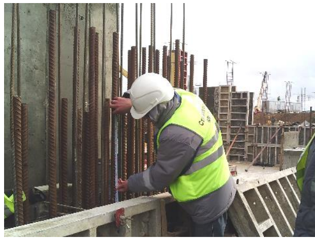
03.2019г. Работы ведет ООО «Мостовое бюро». Здание ДОЛБ Ст. Тамань - Пассажирская. Приемочный контроль установленной опалубки и арматурного каркаса СБ10 отм.-1,800 в осях 11-12/И. (ООО «ЗОДЧИЙ»). Проведены контрольные замеры.
