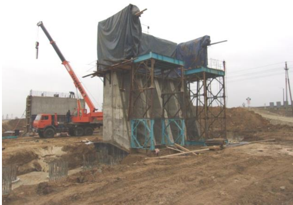
12.2015 г. Работы выполняет ООО «ТЮС - КубаньМост». Железнодорожный путепровод на ПК237+76. Сооружение опоры №2.
