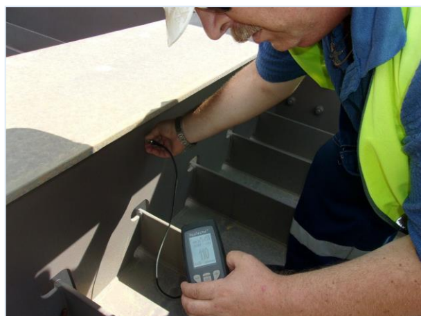
08.2016 г. Работы выполняет ООО «Мостовое бюро». Автодорожный путепровод на ПК42+93,61. Входной контроль металлоконструкций пролётного строения.
