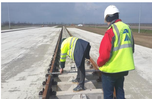
03.2016г. Работы ведет ООО «ДК ПОРТ». Приемочный контроль укладки материалов по главному пути Грузовой двор путь 2.
