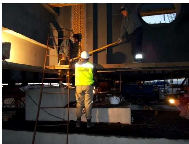
Пролётное строение 208 – 209, ось 2. Устройство сталежелезобетонного пролётного строения (а/д мост). Проверка качества натяжения высокопрочных болтов. Стык крепления домкратной балки. 09.2017
