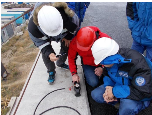
Пролётное строение в осях опор № 171 – 175, ось 4 (а/д мост). Устройство железобетонного пролётного строения. Комиссионное испытание анкеров барьерного ограждения, 11.2017
