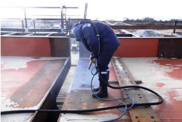
Опора № 145, оси А – Б. Устройство деформационного шва металлического пролётного строения (ж/д мост). Пескоструйная очистка элементов деформационного шва. 11.2018
