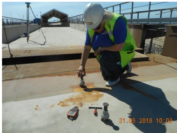
Ж/д пролетное строение в осях опор 189-192. Устройство гидроизоляции металлических балластных корыт системой Элиминатор. Контроль послойной адгезии. Проведение испытаний по определению адгезии методом отрыва. 05.2018
