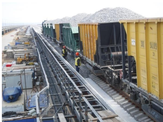
ПС в осях 107 – 108, ж/д мост, II путь, работы по балластировке рельсошпальной решетки щебеночным балластом первым слоем, выгрузка производится хоппер дозаторной вертушкой (ХДВ). 03.2019
