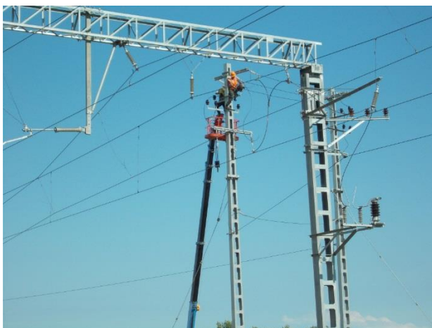
07.2018г. Работы выполняет ООО «ТЮС-МКС». Ст. Вышестеблиевская. ВЛ 10 кВ ПЭ. Выполняются работы по монтажу траверсы.
