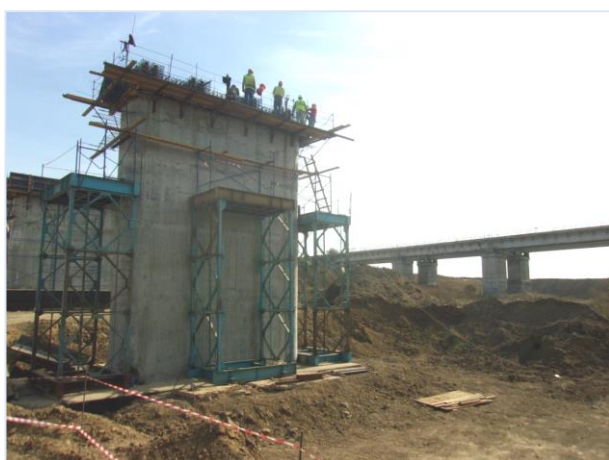
10.2015г. Работы ведёт ООО «ТЮС-КубаньМост». Железнодорожный мост на ПК169+50. Армирование и установка опалубки монолитной насадки промежуточной опоры №3.
