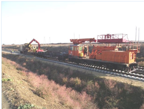
10.2016 г. Работы ведёт ООО «ТЮС-МКС». Устройство ж. д. контактной сети на участке ПК125+00-ПК140+00.
