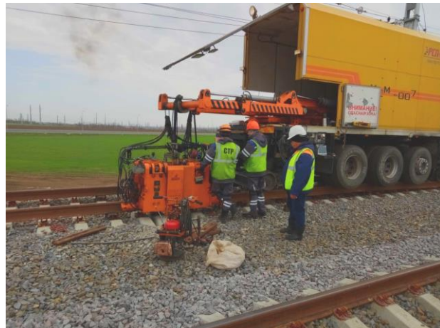
04.2019г. Работы ведет ООО «СПЕЦ-ТРАНСРАЗВИТИЕ». Верхнее строение пути. Бесстыковой путь. Участок ПК314-ПК362. Операционный контроль устройства бесстыкового пути № II ПК338+00.
