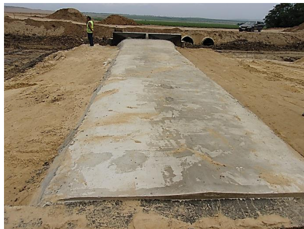
07.2015. Работы ведет ООО «СтройГара». Водопропускная труба КЖБТ2х1,5 на ПК60+42,3. Устройство защитного слоя клеечной гидроизоляции трубы.
