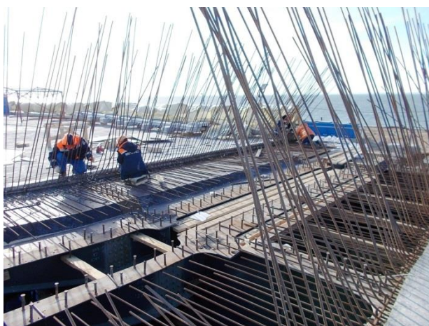
Опора № 211, оси 1 – 2 (а/д мост). Устройство сталежелезобетонного пролётного строения. Армирование монолитной части деформационного шва. 11.2017
