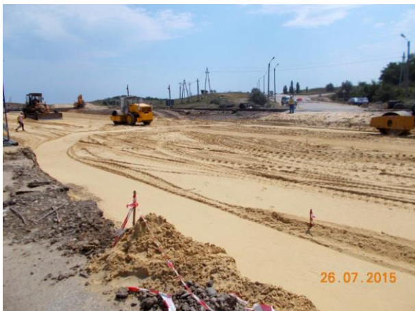
07.2015. Работы ведет ООО «ТЮС МК-105». Переустройство переезда ПК 41+00, устройство защитного слоя насыпи ЗП, планировка и уплотнение 3-го слоя ПК41+00-ПК42.
