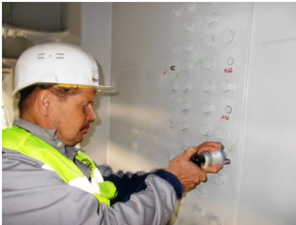
Пролётное строение в осях опор № 196-197 (а/д мост), ось 2. Проведение испытаний по определению адгезии методом отрыва нанесенного лакокрасочного покрытия. 06.2018
