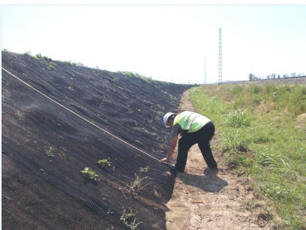
07.2016г. Работы ведет ООО «Мостовое бюро». Приемочный контроль укрепления откосов выемки гидроматами ПК 81+00-ПК87+30(ООО «СМП Трансстрой»).
