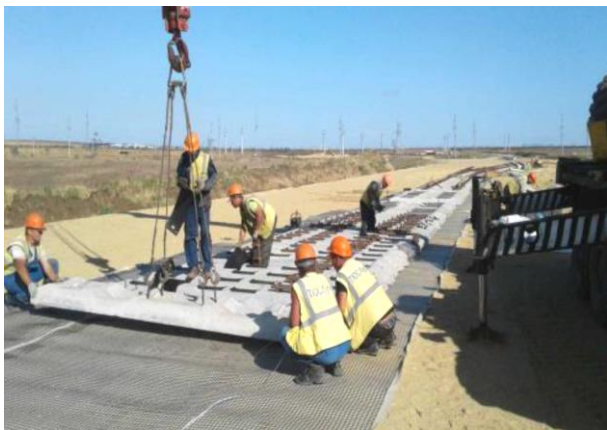
01.09.2017г. Работы ведет ООО «ТЮС-Путь». Путевое развитие. ПК314–ПК362. Операционный контроль поэлементной сборки стрелочного перевода СП10 ПК316+21,32.
