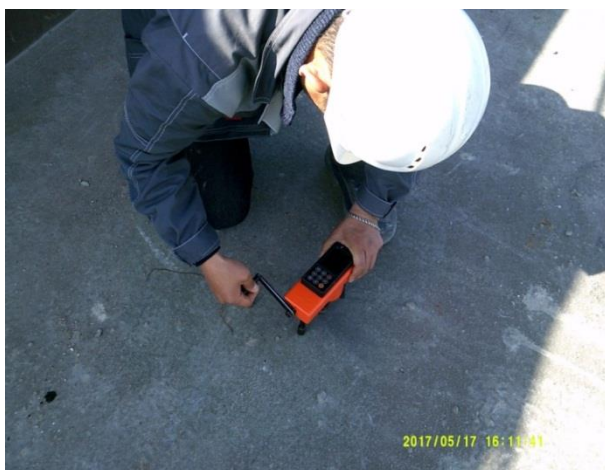
Опора №102 (а/д мост). Проведение испытания на адгезию вторичной защиты верхней поверхности монолитного ростверка опоры. 05.2017
