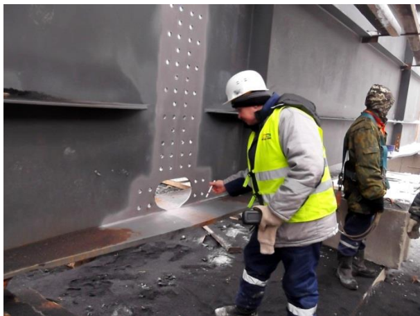
Пролёт 185–186 (а/д мост). Визуально-измерительный контроль сварного шва роспуска. Стык главных балок № 3ГБ14. 01.2017
