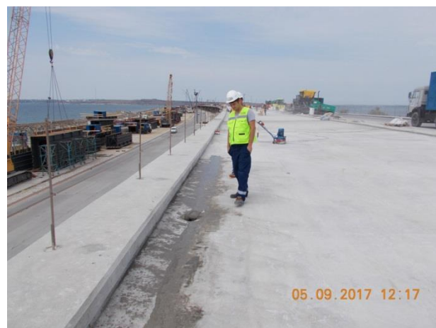
Пролётное строение оп188-190 (а/д мост). Приемка поверхности плиты проезжей части. Определение застойных зон воды проливкой 09.2017
