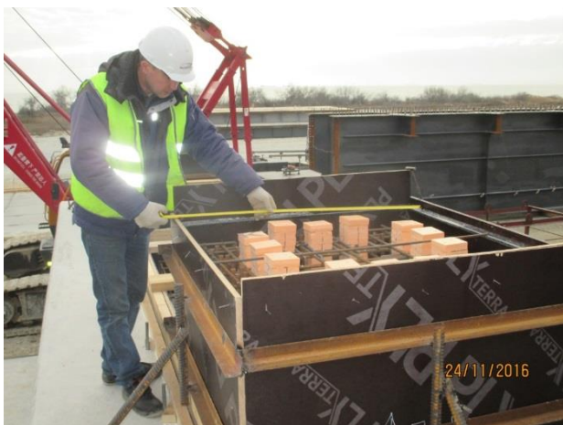
Опора №129 (а/д мост). Приемочный контроль армирования и установленной опалубки подферменников и домкратных площадок. 11.2016.
