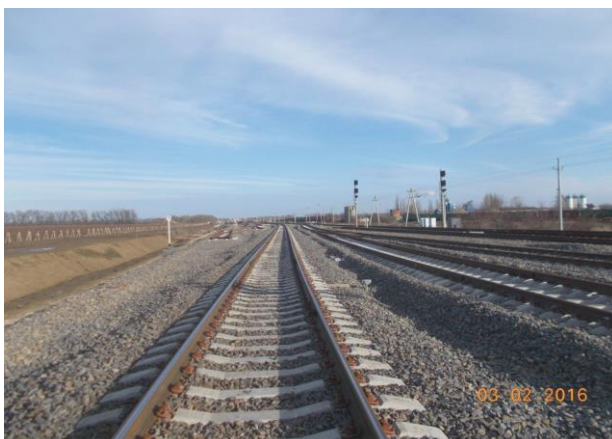
02.2016г. Работы ведет ООО «Трансюзстрой-Путь». Приемочный контроль, укладка рельсошпальной решетки по III пути.
