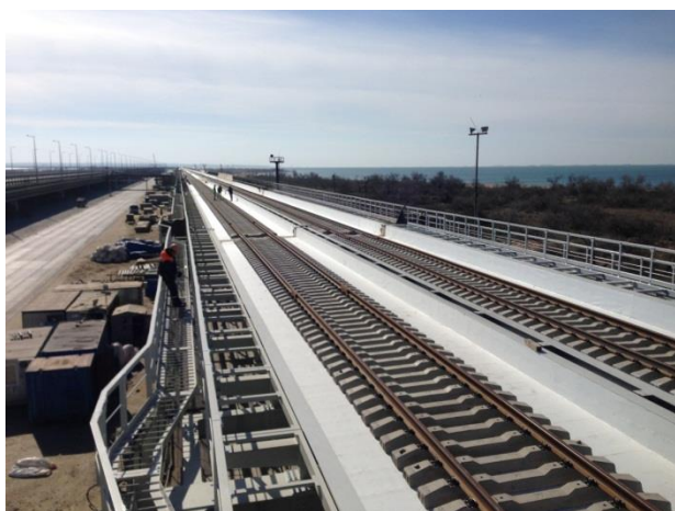
Устройство верхнего строения пути. Вид от опоры №174 в сторону Таманского полуострова (ж/д мост). 03.2019
