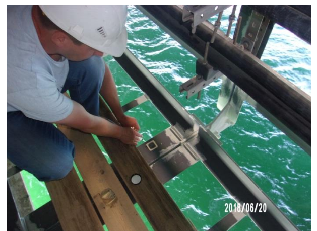
Пролётное строение в осях опор № 102-103 (а/д мост). Устройство антикоррозионной защиты стальных конструкций смотровых ходов в осях главных балок 2 (фасад). Проведение испытаний по определению концентрации водорастворимых солей на поверхностях стальных конструкций. 06.2018
