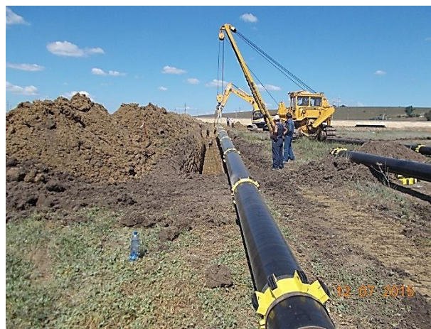
07.2015. Работы ведет ООО «Газстрой». Переустройство магистрального газопровода ПК20+96. Укладка рабочей плети газопровода в траншею для протяжки под ж/д. Приемочный контроль монтажа опорных колец.
