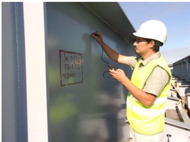
08.2015. Работы ведет ООО «Мостовое бюро». Проверка толщины лакокрасочного покрытия металлоконструкций с завода-изготовителя ЗАО «ЧЗМК». Выявлено уменьшение толщины лакокрасочного покрытия до 120 мкм
