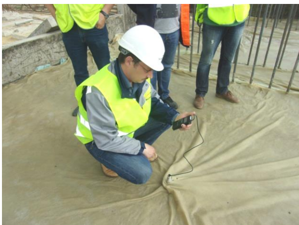
06.2016 г. Работы выполняет ООО «Мостовое бюро». Автодорожный путепровод на ПК42+93,61. Операционный контроль работ ООО «ТЮС-Арена», контроль температуры уложенного бетона ростверка опоры №1.
