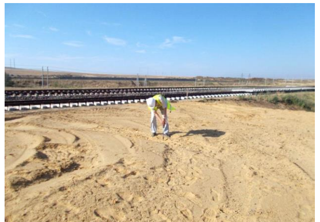
08.2017г. Работы ведет ООО «Мостовое бюро». Путьевое развитие. Пункт обогрева ПК223+85. Операционный контроль уплотнения 13 слоя насыпи площадки пункта обогрева из дренирующего грунта (ООО «ТЮС-СМП-608»). Динамическим плотномером проверено качество уплотнение грунта.
