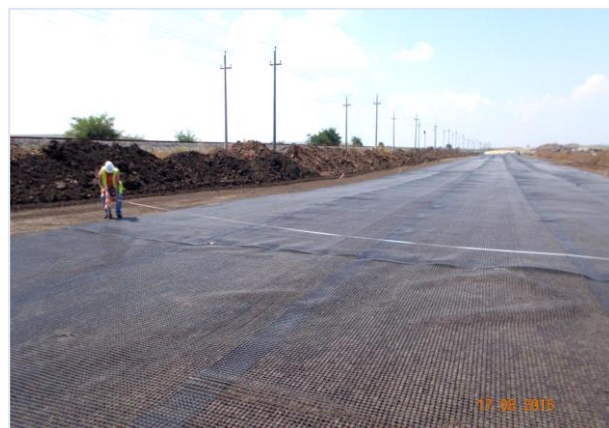
08.2015. Работы ведет ООО «Мостовое бюро». Приемочный контроль укладки георешетки в основании насыпи земляного полотна ПК190+00-ПК195+30.
