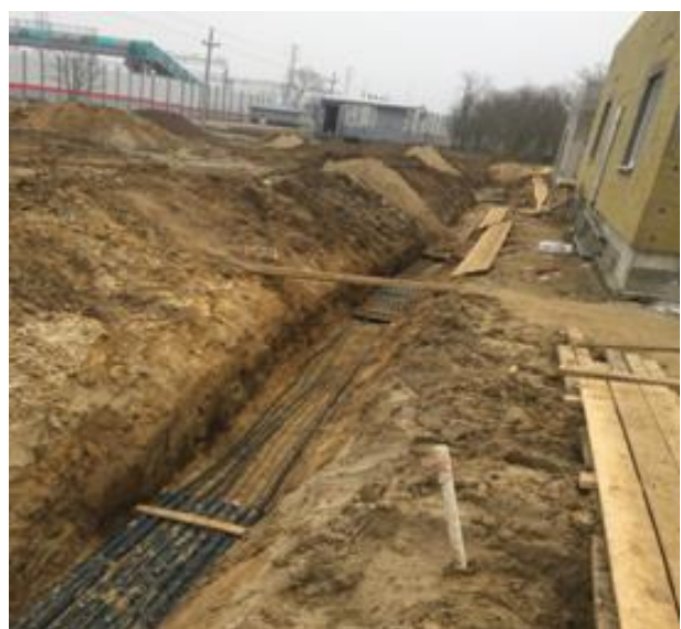
02.2019 г. Работы выполняет ООО «Курортстройинвест» Инфраструктура караульных городков. Ст. Вышестеблиевская. Траншея с уложенными кабелями электроснабжения.
