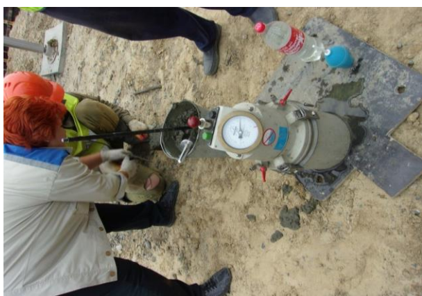
09.2015. Работы ведет ООО «Мостовое бюро», лаборатория ООО УК «Трансюзстрой». Входной контроль бетонной смеси ростверка опоры №2 железнодорожного путепровода на ПК237+76.
