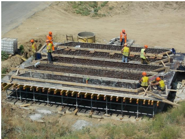
06.2018г. Работы выполняет ООО «Зодчий». Автодорожный путепровод на ПК42+93,61. Выполняются работы по устройству арматурного каркаса и опалубки переходных плит для опоры №1.
