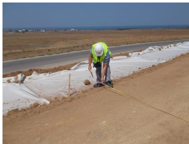
07.2016 г. Работы ведет ООО «Мостовое бюро». Приемочный контроль работ ООО «Радон» устройство нижнего слоя насыпи земляного полотна из недренирующего грунта, ПК240+00-ПК243+00.
