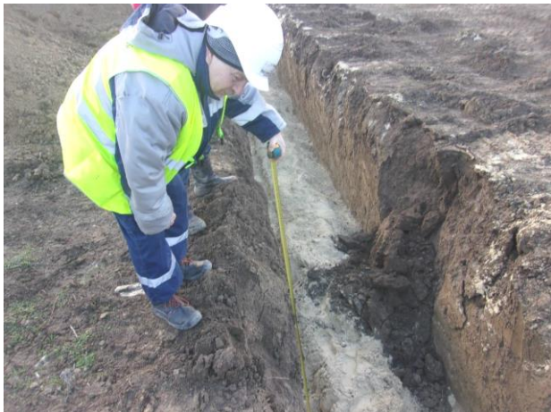
01.2018 г. Работы выполняет ООО «Мостовое бюро». Вынос сети хозяйствен-но-питьевого водопровода на ПК329. Освидетельствование засыпки трубопровода песком.
