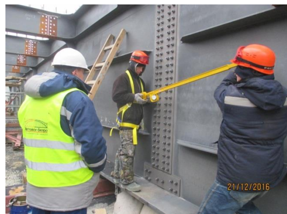
Пролет 131-132 (а/д мост). Контроль натяжения высокопрочных болтов на расчетное усилие в стыках главных балок – узел 4ГБ2. 12.2016
