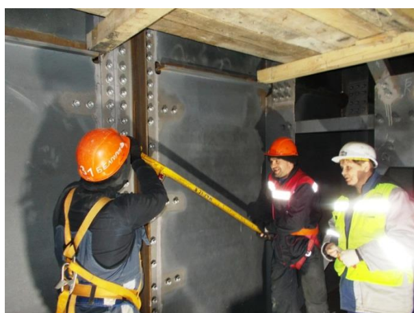
Пролётное строение в осях опор № 170 – 171, оси В, Г(ж/д мост). Устройство металлического пролётного строения. Приёмочный контроль качества натяжения высокопрочных болтов на расчётное усилие. Стык крепления укрупнённого блока Б3н/Б4н к укрупнённому блоку Б5/Б6 ГМ4. 02.2018
