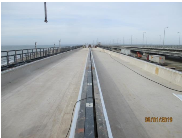
ПС в осях опор №106-№108 (ось А-Б, В-Г) - ж/д мост. Антикоррозионная защита внутренних поверхностей балластного корыта. Нанесение гидроизоляционной системы Элиминатор на внутренние поверхности балластного корыта и на элементы деформационных швов. 01.2019
