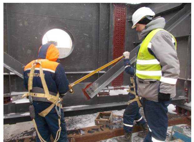
Пролет 133-134 (а/д мост). Приемочный контроль натяжения высокопрочных болтов на поперечной связи в узлах ЗСВ40, 4СВ40, ЗСН40, 4СН40, 34С40. 01.2017
