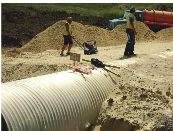
06.2015 Работы ведет ООО «ТЮС-Север». Водопропускная труба СМГТ 2,0 на ПК228+88. Послойное уплотнение обратной засыпки. Замечаний нет.
