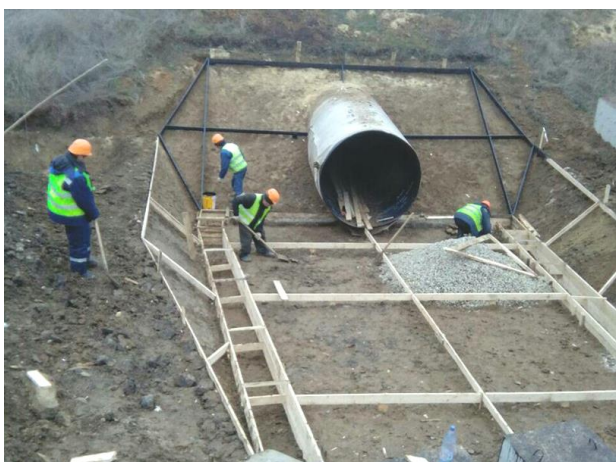
02.2018г. Работы выполняет ООО «Южгазстрой». Водопропускная труба на СМГТ на ПК183+01,60. Выполняются работы по устройству укрепления входного оголовка трубы.
