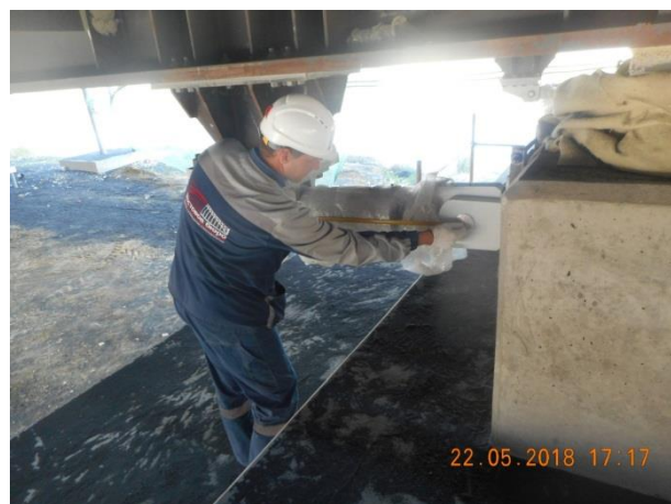
Опора №152 (а/д мост). Инспекционный контроль смонтированных шок-трансммиттеров и опалубки перед устройством подлива под левый соединительный элемент, в осях главных балок 1-4. 05.2018
