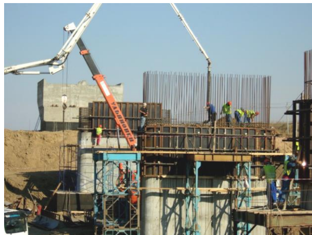
09.2015. Работы ведет ООО «ТЮС-КубаньМост». Бетонирование тела опоры №3 (3 этап) железнодорожного моста на ПК169+50.
