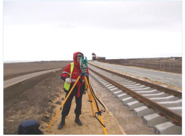
11.2016г. Работы ведет ООО «Мостовое бюро». Геодезический контроль укладки рельсошпальной решетки по оси II пути. ПК240+00-ПК249+80.
