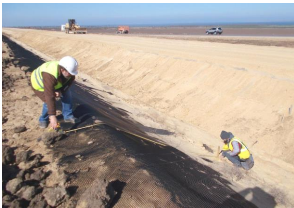
03.2016г. Работы ведет ООО «Мостовое бюро». Приемочный контроль укладка гидроматов по левому откосу выемки земляного полотна. ПК 158+80-ПК 164+80 (ООО «ТЮС-МК105»).
