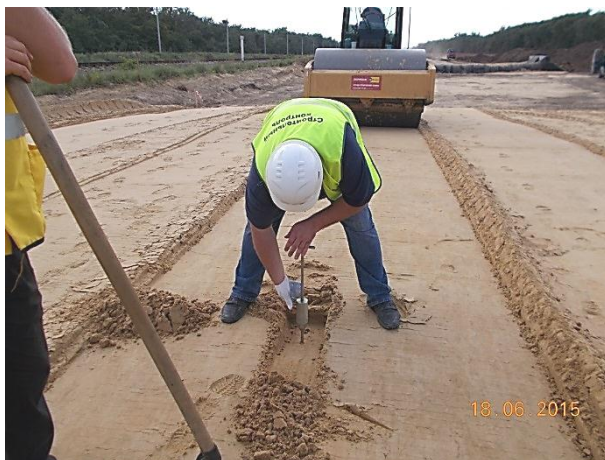
06.2015. Работы ведет ООО "Мостовое бюро". Устройство насыпи ЗП ПК 47+80-ПК 50+60. Проверка качества уплотнения плотномером ДПУ-Кондор.
