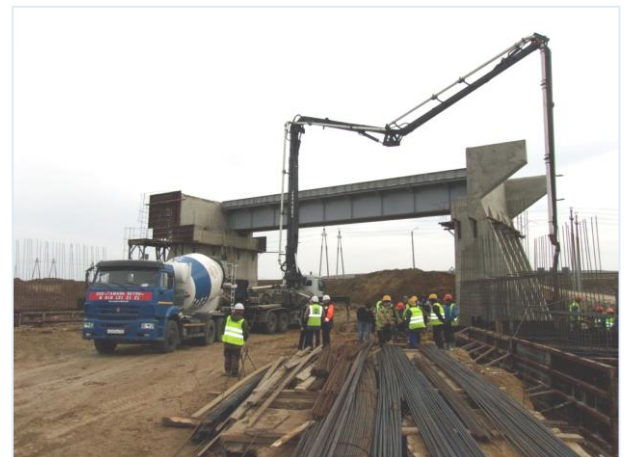
03.2016 г. Работы выполняет ООО «ТЮС-КубаньМост». Железнодорожный Путепровод на ПК237+76, сооружение подпорных стен. Бетонирование ростверков подпорных стен посредством бетононасоса.
