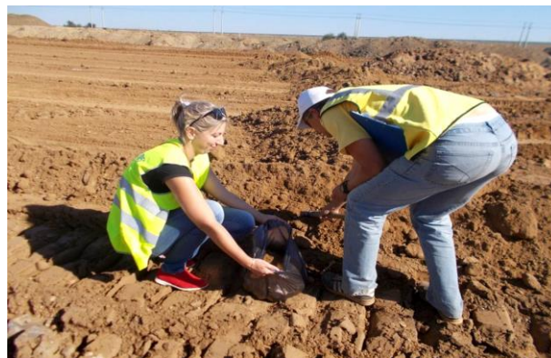
09.2016г. Работы ведет лаборатория ООО «ТЮС МК-105». Отбор проб на определение физико-механических свойств грунта для устройства 2 слоя насыпи земляного полотна из недренирующего грунта. ПК282+50
